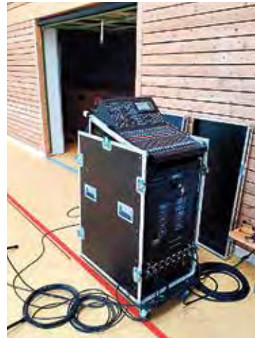
Hifi-Rack in der Sporthalle Nord
