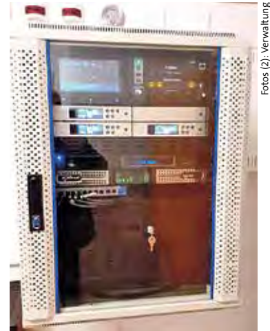
Hifi-Rack in der Sporthalle Süd
